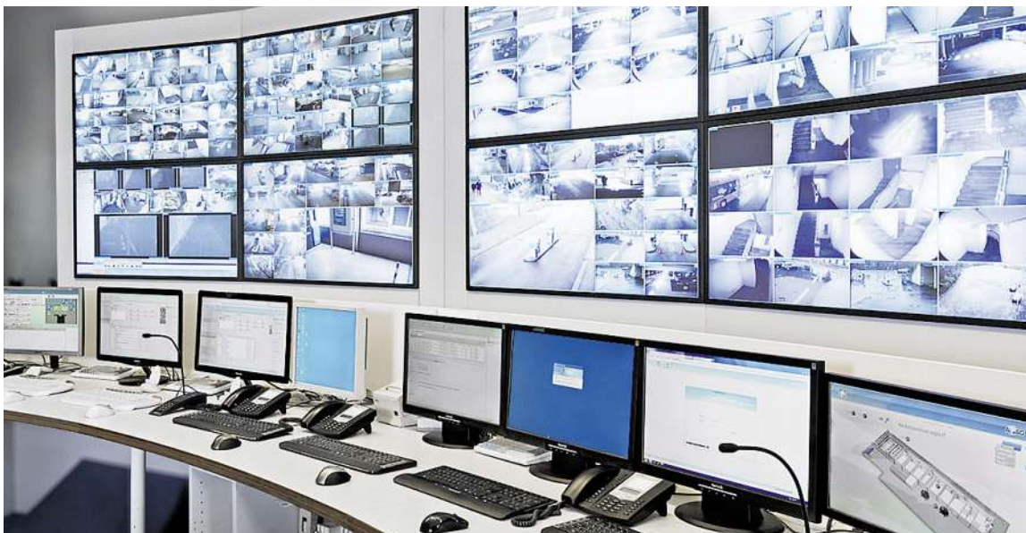
Vom Leitstand aus werden alle Parkhäuser Tag und Nacht überwacht. Foto: APAG
